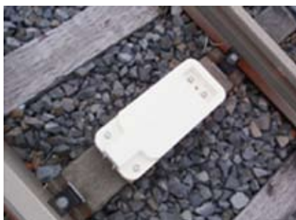
RW地上子設置状況
