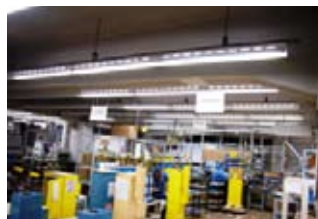
NTサイトの省エネ蛍光灯更新
