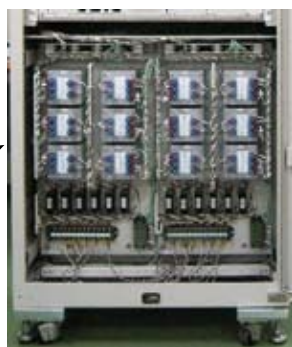
ブロック保守にスライド方式を採用したトランス部(拡大)
