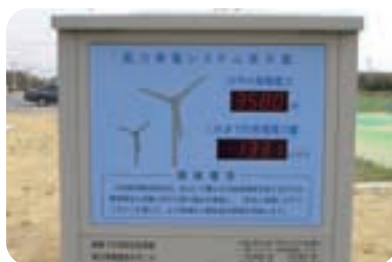
風力発電システム表示盤
