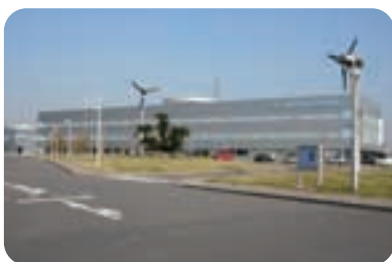
風力発電システム
